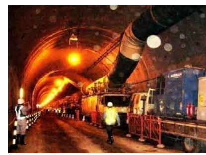
東工事切羽付近換気設備
