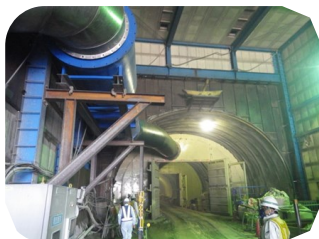
防音ハウス 換気設備及び二重防音扉
